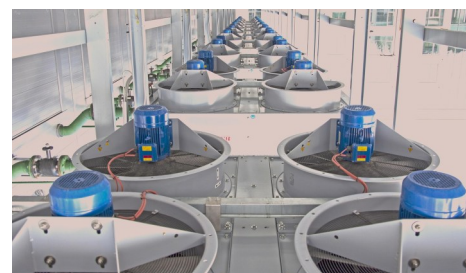
Echappement, pressurisation CRAC&CRAH refroidissement, ...
