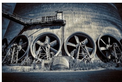
Ventilateurs de refroidissement, ventilation, extracteurs ...
